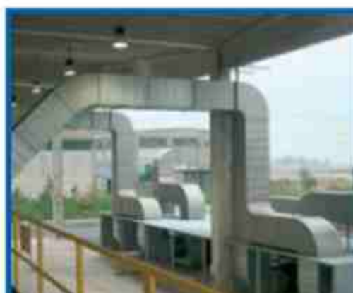
Impianto di trattamento R.S.U. Brindisi Committente: E.M.I.T. SpA Milano
