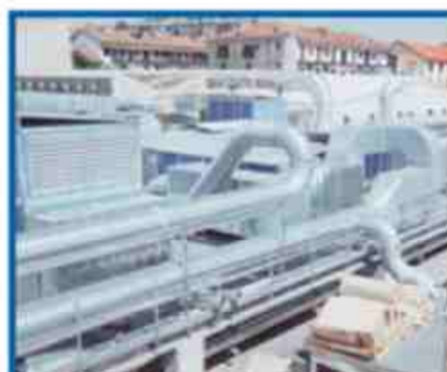
Atelier ORMANIO Milano Committente: F.D.S. Impianti SpA Gruppo Colathex Milano
